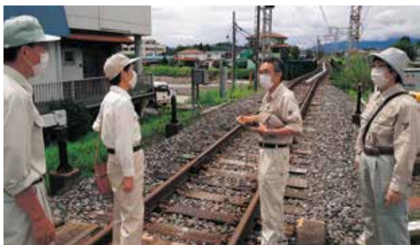
橋台が傾き鉄道が不通に(辰野町・8月19日)
