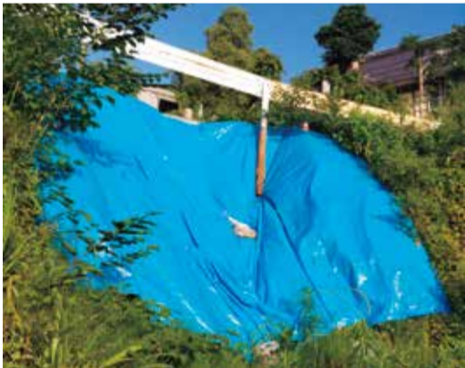
昨年の災害復旧工事が進んでいない県道地域住民と視察、建設事務所に工事の早期着手を要望(七二会)
